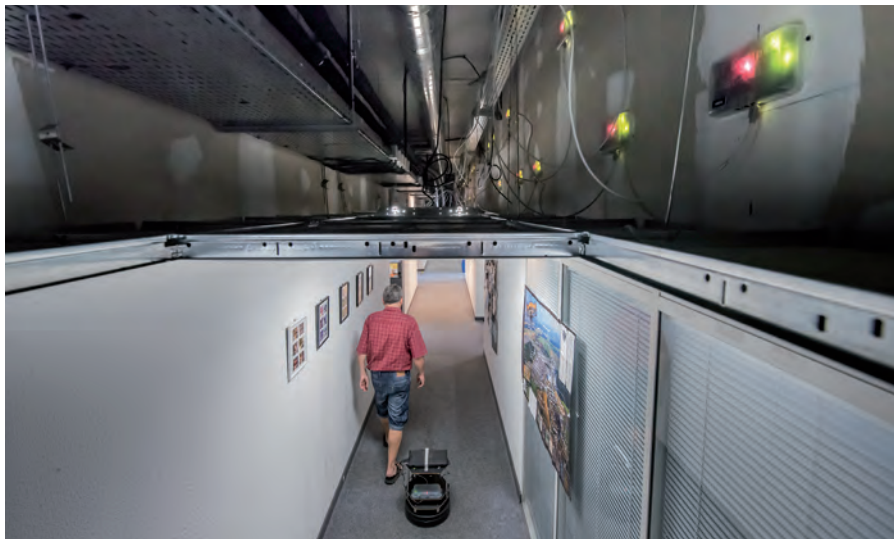
Réseau de capteurs FIT/IoT Lab installés dans le centre Inria Grenoble Rhône-Alpes. © Inria / Photo H. Raguét.
